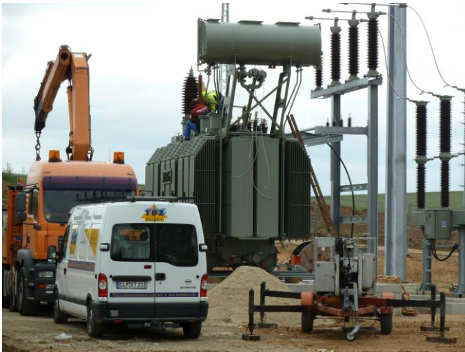
Wind Works 110 kV Umspannwerk
